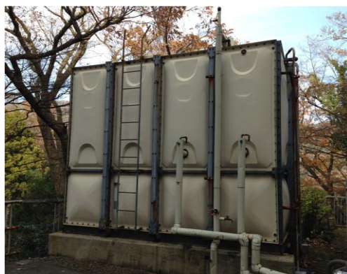
【貯水槽水道（県保健福祉事務所所管域）】
