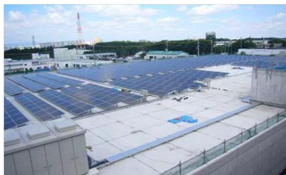
【川井浄水場太陽光発電設備（横浜市）】
