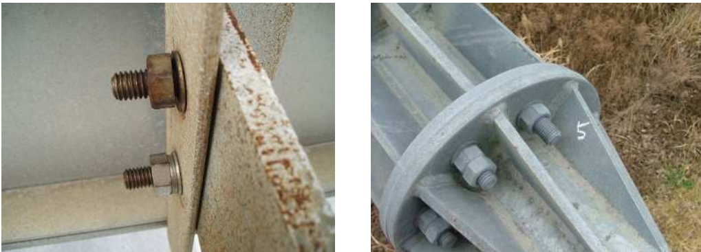
写真-解 8-9 設置後 10 年以内の附属物の変状事例
