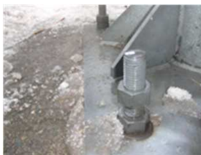
写真-解 6-1 設置後1年程度の附属物のアンカーボルトのゆるみ
