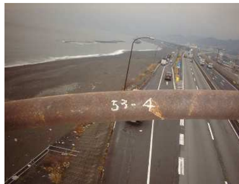
写真-解 8-10 支柱本体の腐食事例
