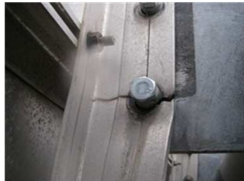
取付部の変状状況
