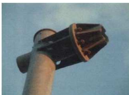
標識横梁基部の破断による標識板落下 （強風の多い海岸付近、2年経過）
