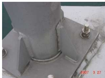
標識柱基部溶接部の亀裂
